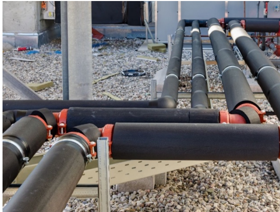
Gambar 9. Perpipaan yang dilengkapi insulator
