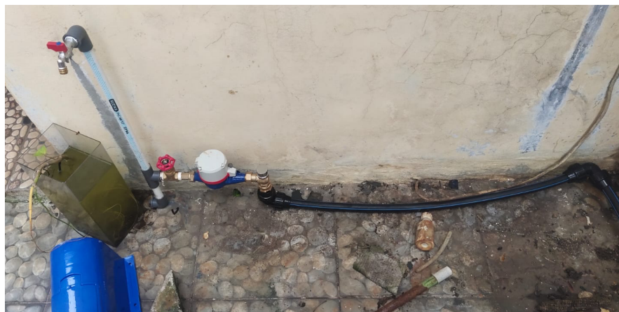
Gambar 7. Pemasangan Sambungan Tidak sesuai Standar
