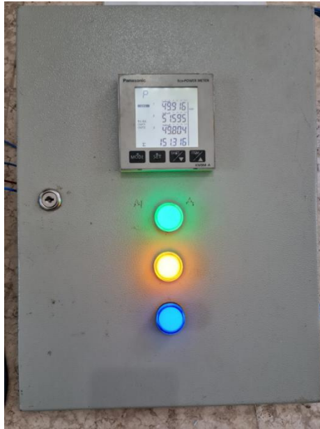
Gambar 3 Alat Ukur Power Meter
