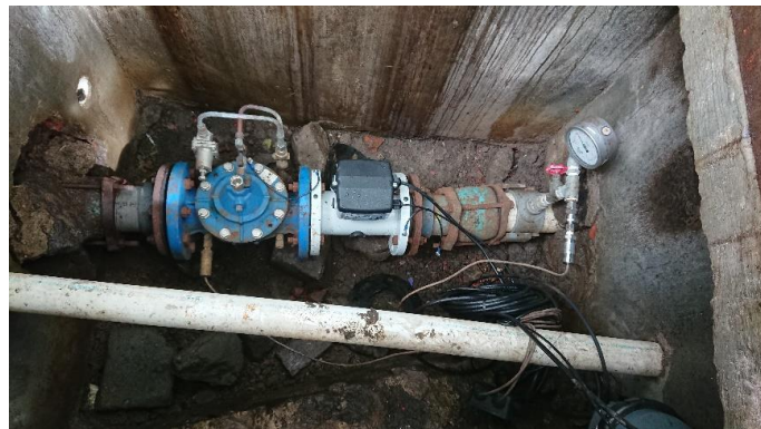
Gambar 5 Instrumen yang Terpasang pada Inlet DMA Sindang Rasa
